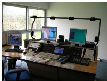
Postes de réception pour les appels de détresse
